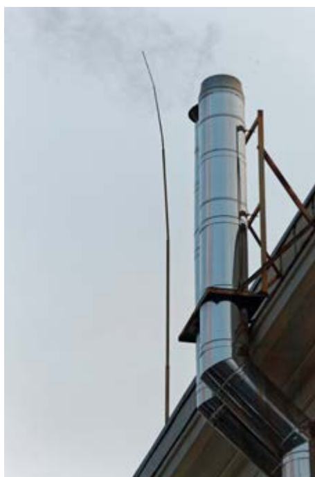
Рис. 2.4.2 - Остаточная деформация (изгиб) молниеприемника
